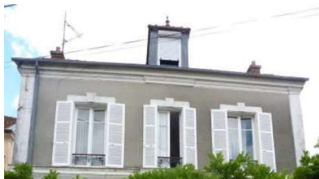
Le caisson du volet roulant alourdit complètement la lucarne.
